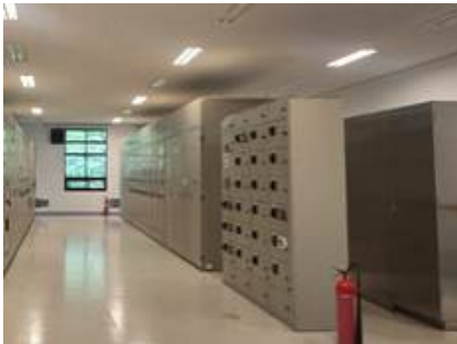
<전기실 수변전설비 상태양호>
