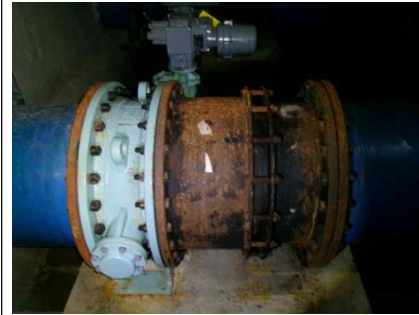
<유입배관실 배관설비 관부식>
