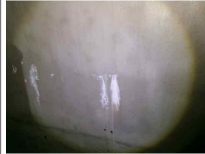
<유입배관실 벽체 균열부백태>
