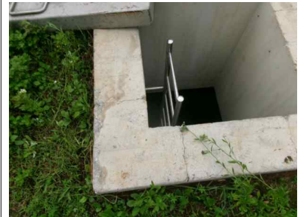
<유입배관실 입구부 균열>
