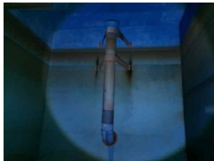
<배수지 3지 유입배관 부식>
