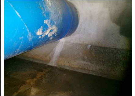
<유입배관실 벽체 균열부백태>
