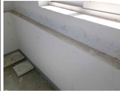
<전기실 내부 균열(0.3mm미만)>
