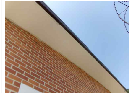
<3~4호지 검수실 외부 균열(0.3mm미만)>
