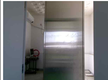
<전기실 내부 전경>
