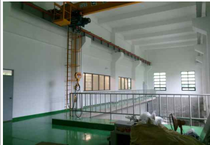
<펌프실(지상) 내부 전경>
