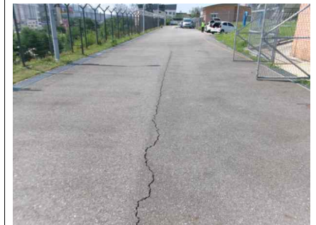
<장내포장 아스콘 균열>
