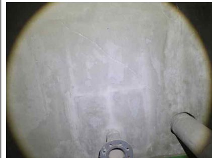
<유출배관실 벽체 균열>
