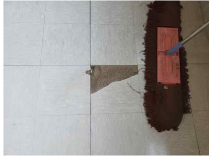
<전기실 바닥슬래브 타일박락>
