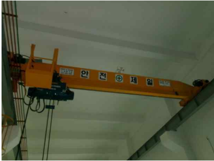
<펌프실 호이스트 상태양호>
