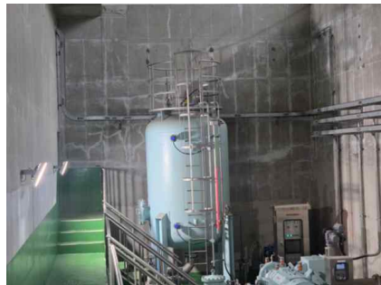
<펌프실 지하 설비 전경>
