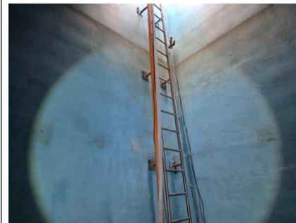
<배수지 2지 점검사다리 상태양호(1구역)>
