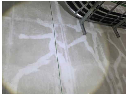
<펌프실 지하 내부벽체 망상균열>
