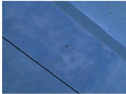
<배수지 2지 상부슬래브 녹 발생>
