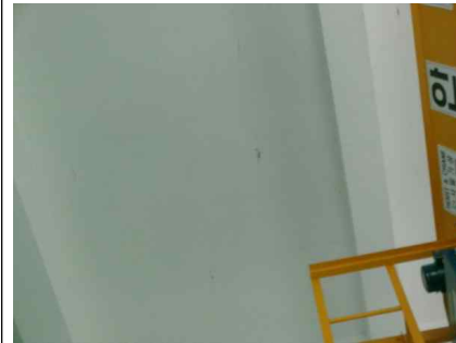
<펌프실 지상1층 상부슬래브 누수흔적>
