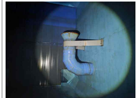
<배수지 1지 유입배관 부식>
