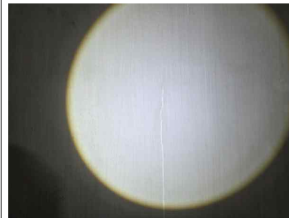
<1~2호지 유입밸브실 벽체 균열부백태>
