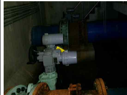
<배관실 유입밸브 상태양호>
