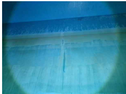
<배수지 3지 벽체 균열부백태>
