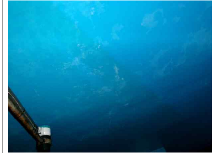
<배수지 2지 상부슬래브 균열부백태>
