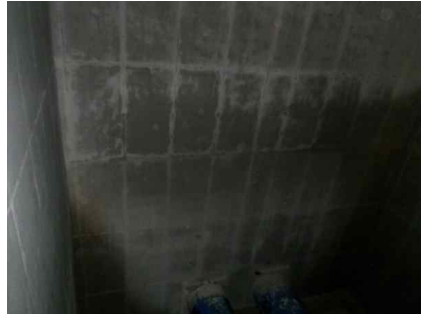
<유량계실 내부 상태양호>
