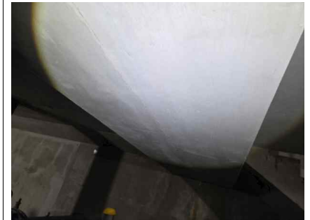
<3~4호지 유출밸브실 상부슬래브 균열>
