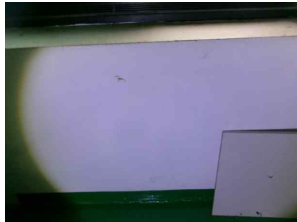
<펌프실 지상1층 벽체 물탈균열>
