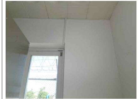
<전기실 내부 균열(0.3mm미만)>
