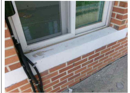
<1~2호지 검수실 외부 균열(0.3mm미만)>
