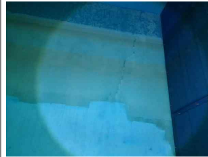
<배수지 3지 벽체 균열>
