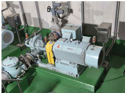
<펌프실 지하 설비 전경>
