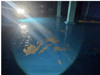
<배수지 1지 바닥슬래브 도장박리>
