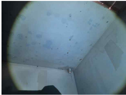
<배수지 2지 상부슬래브 녹 발생>
