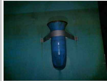
<배수지 4지 유입배관 부식>
