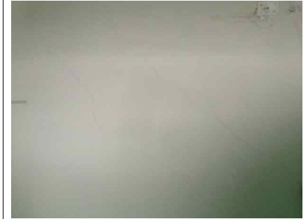
<펌프실 지상1층 벽체 물탈균열>
