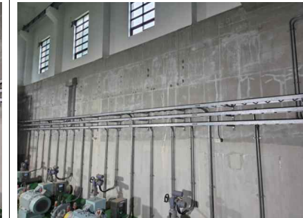
<펌프실 지하 내부 전경>
