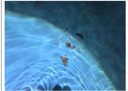
<배수지 2지 바닥슬래브 도장박리>
