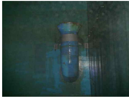
<배수지 2지 유입배관 부식>
