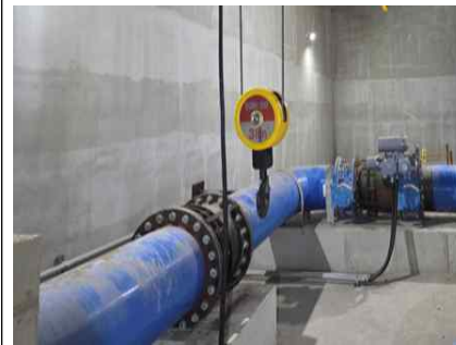
<유입 밸브, 배관, 볼트류 상태양호>
