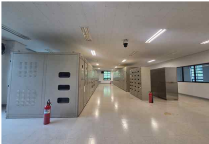
<전기실 내부 전경>
