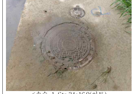
<송수-1 Sta.34+16.9(이토) 맨홀 뚜껑 고착으로 인한 인력개폐 불가>
