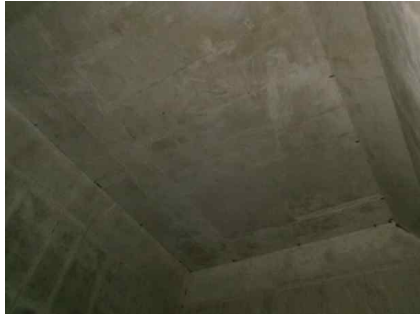
<유량계실 내부 상태양호>
