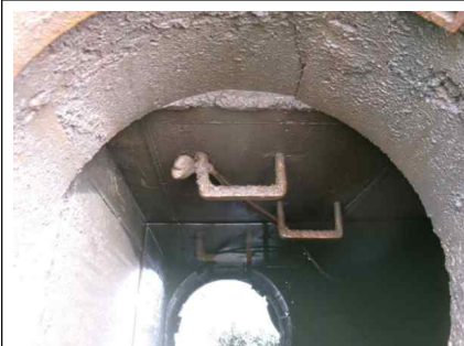
<송수-2 제수밸브실 사다리 설치 상태양호>
