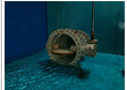
<저류지 유출 수동밸브 상태양호>
