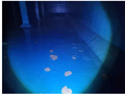
<배수지 2지 바닥슬래브 도장박리>
