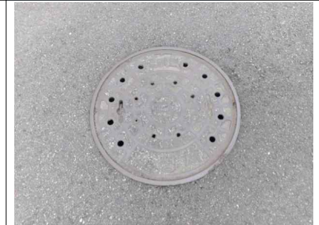
<송수-2 Sta.17+10.0(공기) 맨홀 뚜껑 고착으로 인한 인력개폐 불가>
