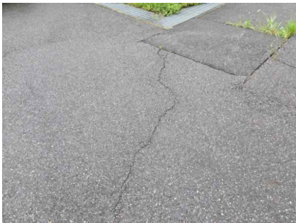
<장내포장 아스콘 균열>
