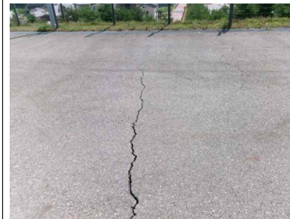
<장내포장 아스콘 균열>
