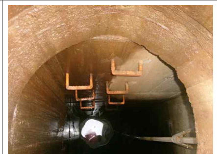
<송수-3 이토밸브실 사다리 설치 상태양호>
