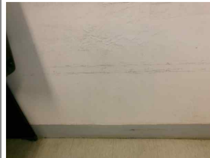
<사무실 벽체 물탈균열>
