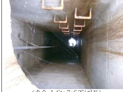
<송수-1 Sta.7+6.35(이토) 밸브실 침수(H=4.2m)>
