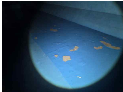
<배수지 1지 바닥슬래브 도장박리>
