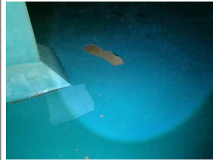
<배수지 3지 바닥슬래브 도장박리>
