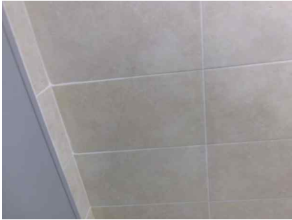
<화장실 벽체 타일균열>
