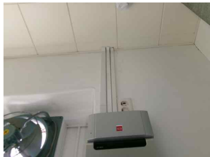
<전기실 내부 균열(0.3mm미만)>
