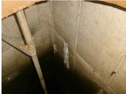
<송수-3 Sta.12+0.0(이토) 벽체 백태 발생(3EA)>
