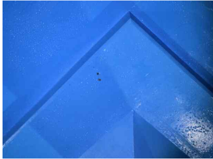
<배수지 1지 상부슬래브 녹물>
