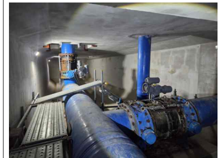
<유출 밸브, 배관, 볼트류 상태양호>
