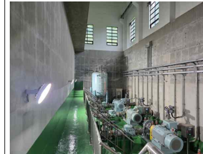
<펌프실 지하 내부 전경>
