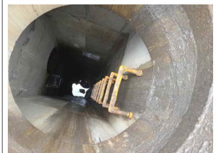
<송수-1 이토밸브실 사다리 설치 상태양호>
