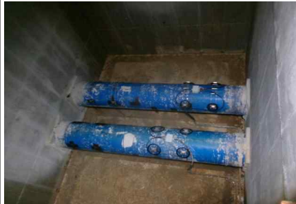
<유량계실 내부 전경>
