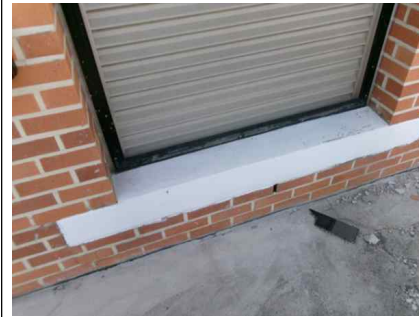
<1~2호지 검수실 외부 균열(0.3mm미만)>
