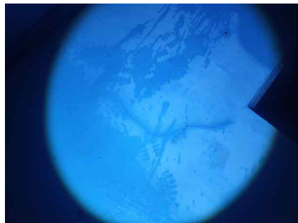
<배수지 4지 바닥슬래브 균열>
